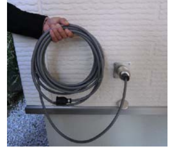
非常時給電システム
